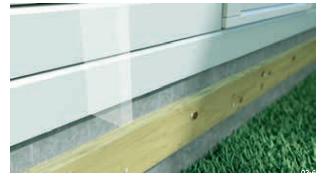
03-6 På trevegg settes terrassebjelken fast i stenderne i veggen eller i kantbjelken som ligger på grunnmursvillen. På liggende panel ser du stenderne ved å finne spikerne i panelet. På stående panel finner du ofte stenderne ved å se nederst på veggen under panelet.
